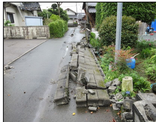
図 ブロック塀の倒壊例
